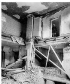
Разрушения внутри дома после взрыва на даче П. А. Столыпина.
